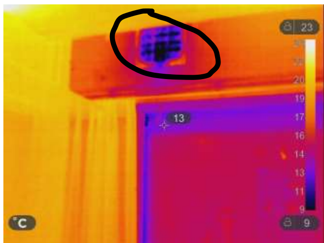
Ventilatie voorziening keuken (binnenzijde)
